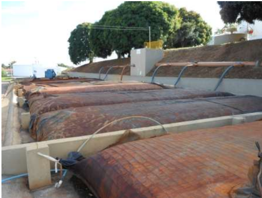
Foto 31: Resíduos sólidos oriundos do tratamento de água na ETA
