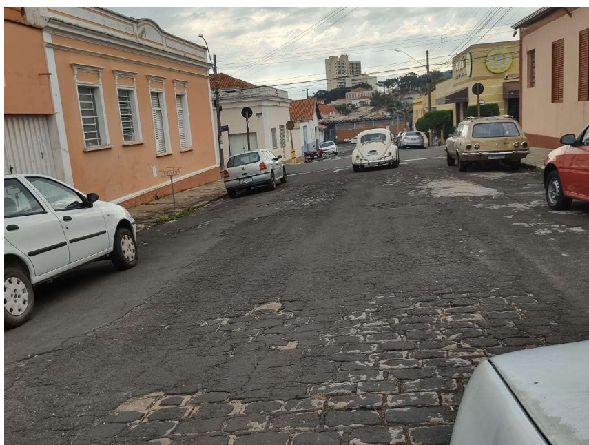
F 16 (17/Mai/21): Vista da Rua Pinheiro Chagas, T-5.1, entre a Rua Dr. João Mendes e a Rua Cel. Joaquim Leite, no Centro. Altura do nº 82, visada sentido Rua Cel. Joaquim Leite.
