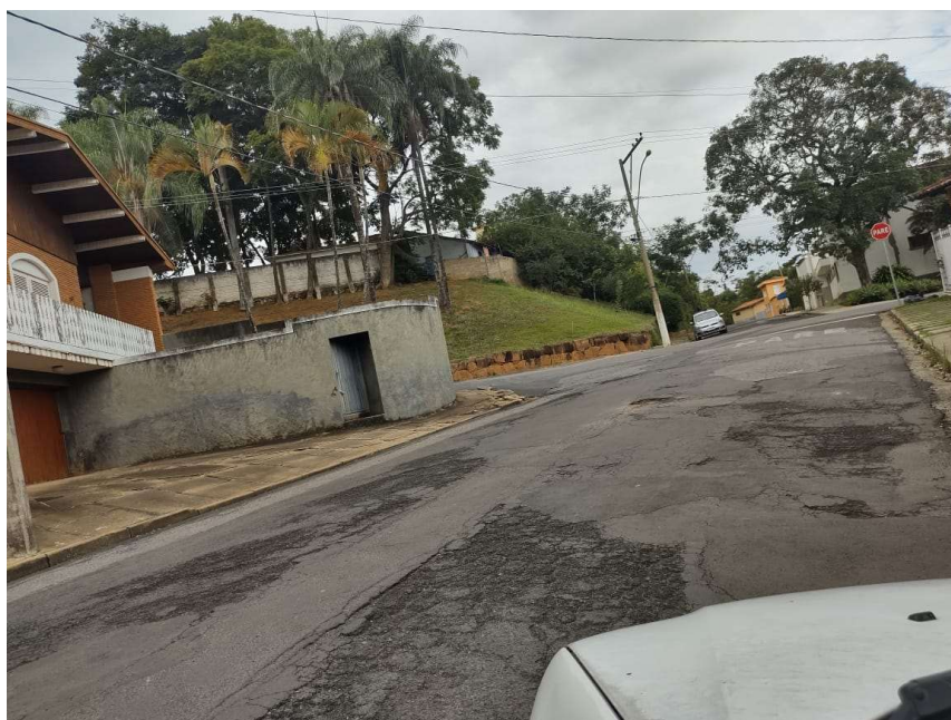
F 22 (17/Mai/21): Vista da Rua Cap. Carlos Teixeira, T-6.7, entre a Rua Guerino Costa e a Rua Santa Cruz, na Vila Norma. Altura do nº 367, visada sentido Rua Santa Cruz.
