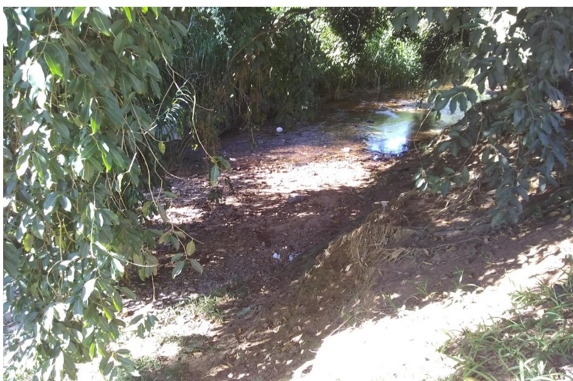
Foto 14: Vista parcial do trecho totalmente assoreado.
