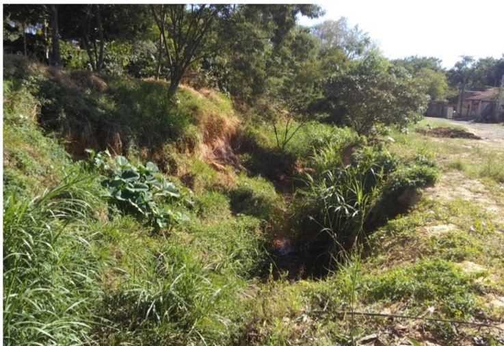
Foto 17: Vista parcial da limpeza e assoreamento do trecho.
