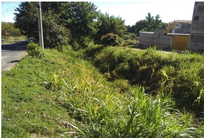
Foto 19: Vista parcial do trecho que necessita da limpeza e desassoreamento.
