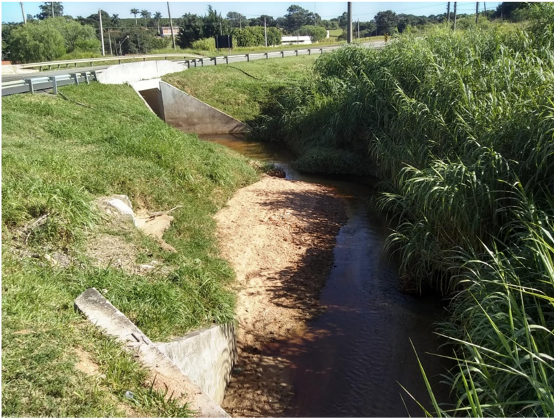
Foto 15: Vista geral do assoreamento no trecho.
