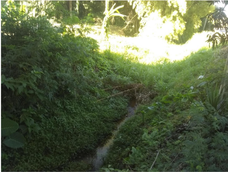
Foto 01: Vista parcial do trecho assoreado.
